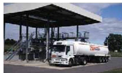
4 postes de chargement (pétrole et gaz)
